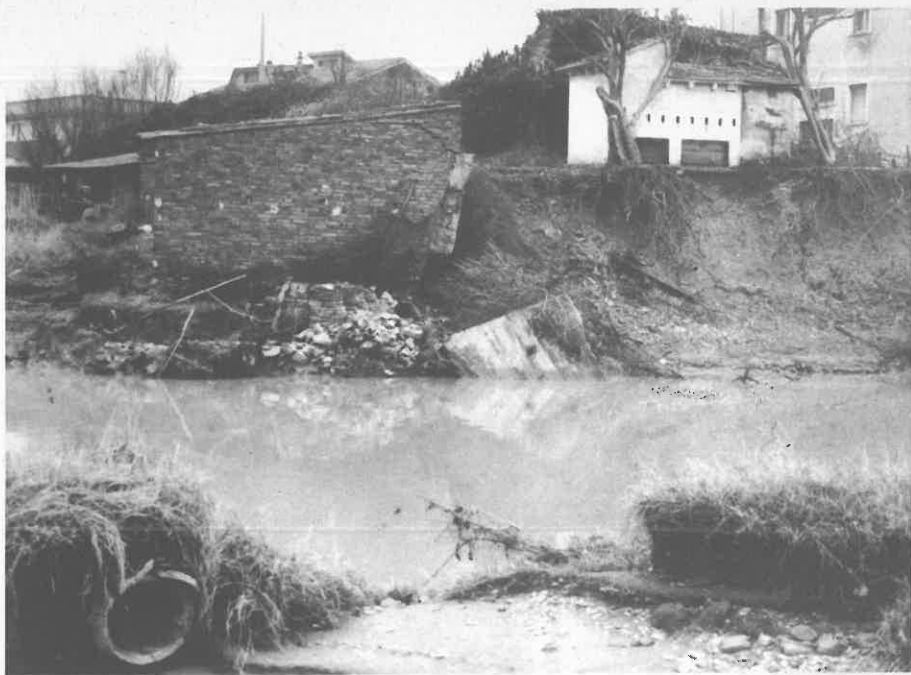
Fig. 19 – Nubifragio del novembre 1979. Il T. Arzilla presso l'abitato di Fanò ha causato ingenti danni alle costruzioni situate imprudentemente nel suo alveo di piena. (foto Dionisi)
